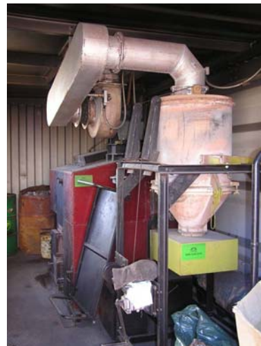
Рисунок 2. Инсинератор ИИ-50 на станции Прогресс
