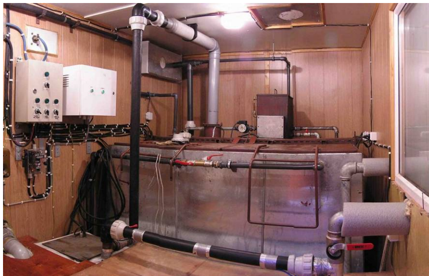
Рисунок 3. Установка для очистки сточных вод станции Прогресс
